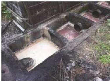
導入前の排水
