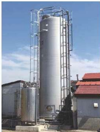
オゾン反応槽と生物処理槽
