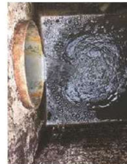
沈殿槽なしで河川放流
