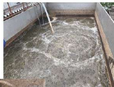
稼働後の曝気槽
