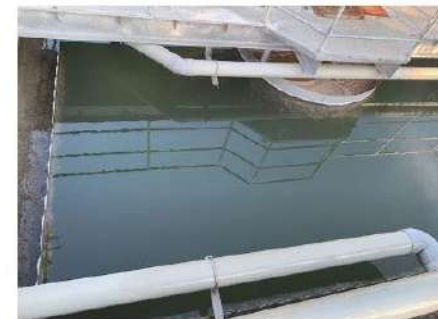
導入後の沈殿槽
