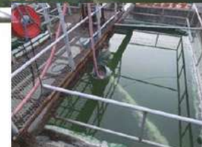
導入後の沈殿槽
