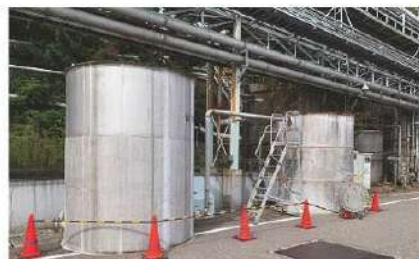
オゾン反応タンクと 生物処理タンク
