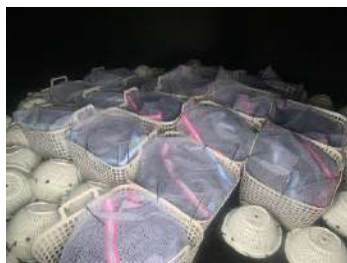
生物処理槽内部の担体
