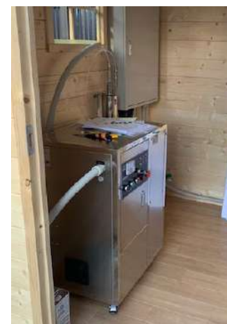
オゾン発生装置
