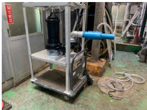
MNB発生装置（原水槽に設置）
