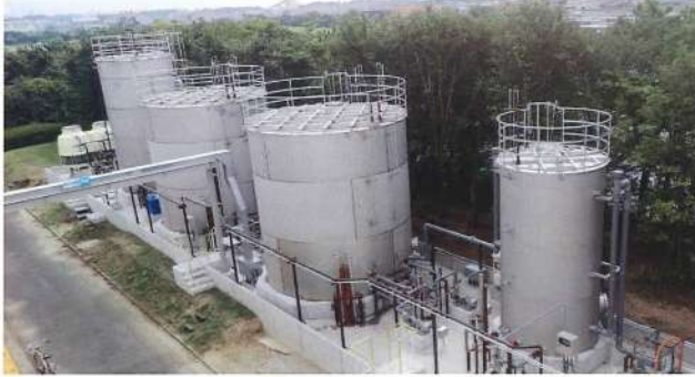
▶中国電力株式会社様の水処理プラント
